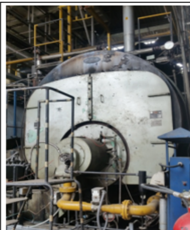
CALDERA DISTRAL DE 900 BHP
