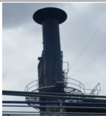
DUCTO UNIFICADO DE LAS CALDERAS COLMAQUINAS Y DISTRAL
