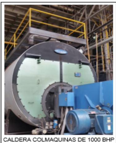
CALDERA COLMAQUINAS DE 1000 BHP
