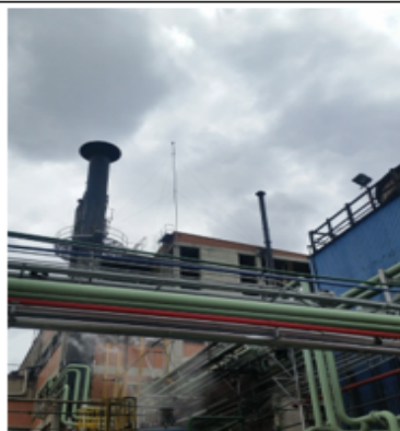
VISTA LATERAL DEL ESTABLECIMIENTO (DUCTO CALDERA COLMAQUINAS Y DISTRAL)
